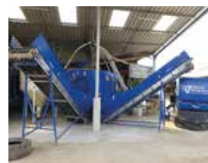
Photo 5.13 : Mélangeuse fixe Delaval équipée d'une double sortie par convoyeur
