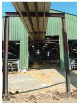
Photo 7.3 : Rail fixé sur portique. Le rail électrifié est protégé des intempéries par une tôle
