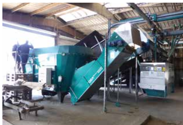
Photo 6.9 : L'automate passe et se charge directement sous les stockeurs et sous un convoyeur chargé d'apporter le foin
