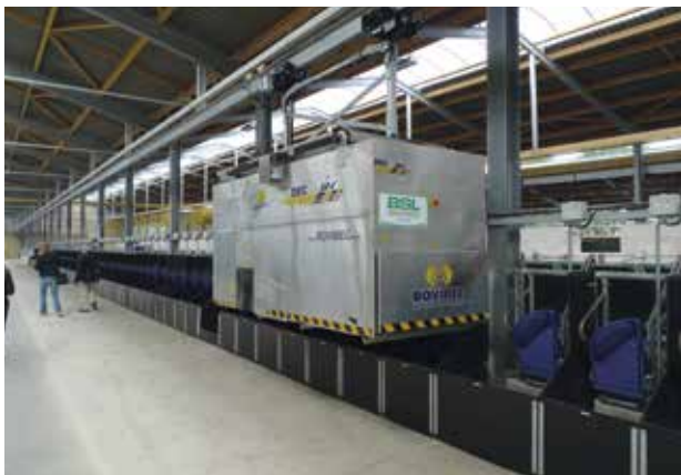
Photo 7.1 : L'automate DEC de Rovibec est ici suspendu sur un rail fixé sur la charpente
