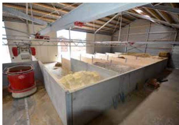
Photo 6.11 : Cellules pour stockage au sol des fourrages en vrac
