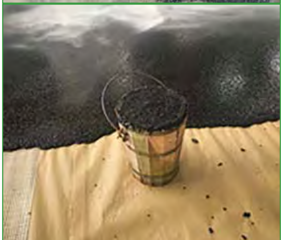
Photos 6 et 7 : L'utilisation de seaux en bois vient du fait que l'asphalte ne colle pas à l'intérieur et que le bois diminue le risque de brûlures des compagnons
