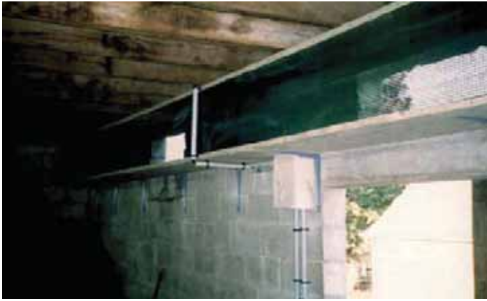
Entrée d'air par un caisson diffuseur
